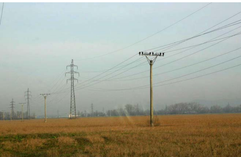
Stĺpy ošetrené hrebeňovými zábranami - Čachtice
