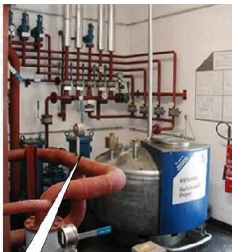
Obrázok 6.27: Čerpacia stanica č. 2 s filtrom a odpadovou nádobou na čistenie filtra
